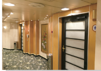
防火认证墙体材料 (实芯墙体装饰板) Fire rated bulkhead (Marine board)
